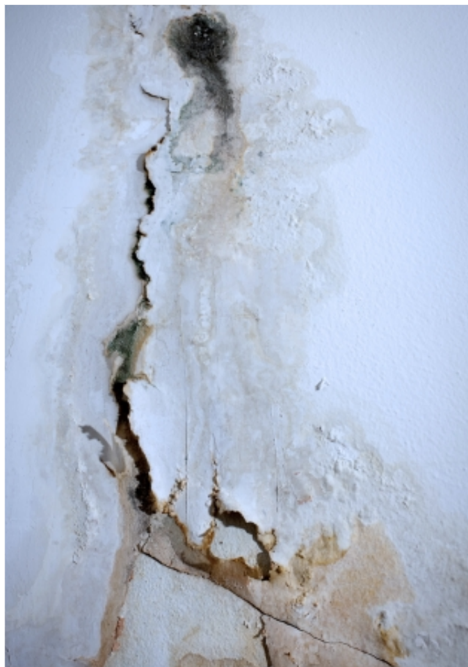
Distacco d'intonaco e muffe dovute a umidità nella muratura.
