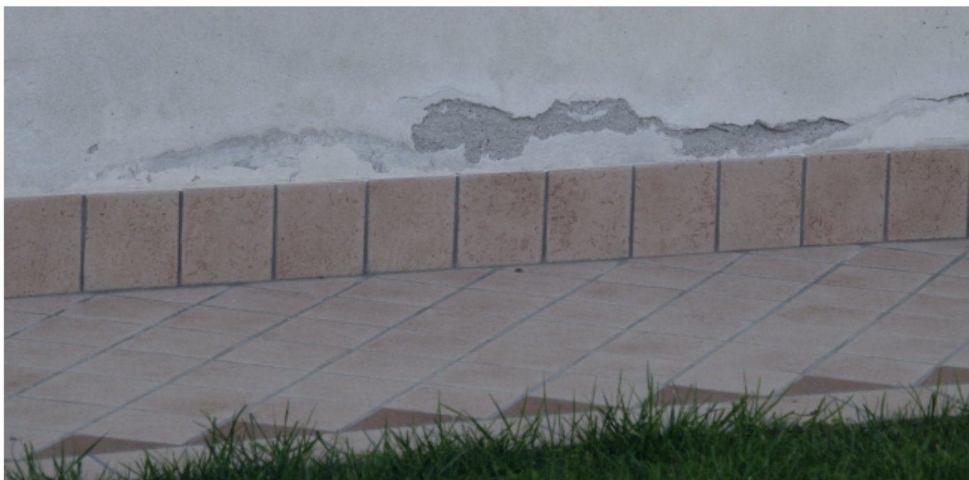
Muratura soggetta a risalita di umidità.
