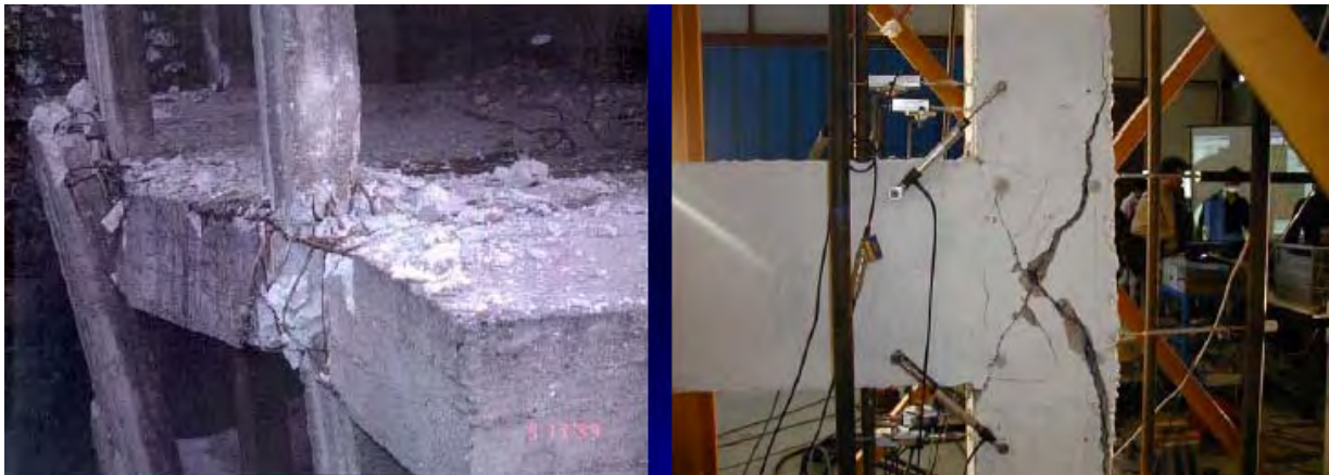
ROTTURA DEI NODI ESTERNI
