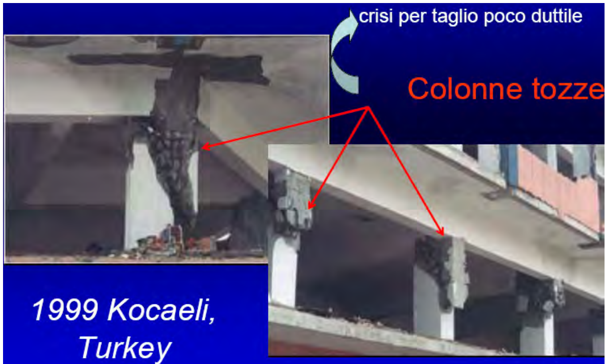
ROTTURA DI COLONNE TOZZE
