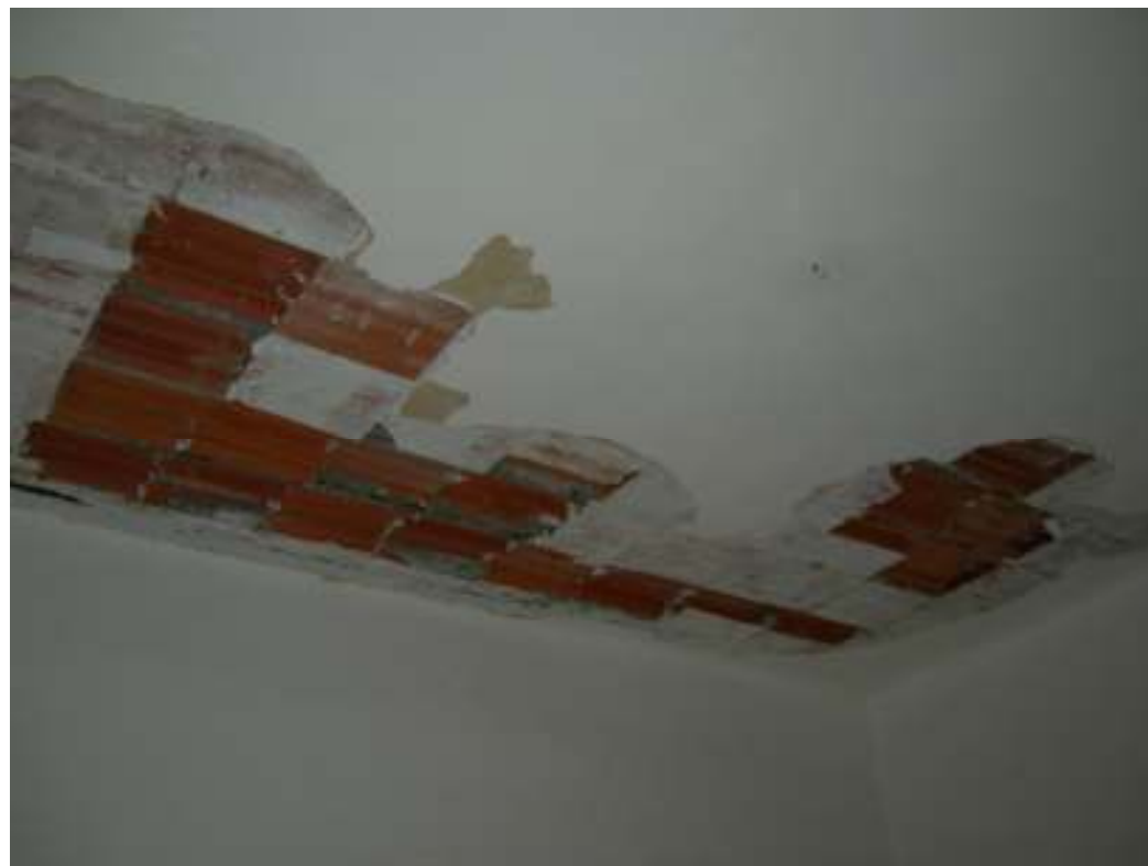
Distacco dei fondelli delle pignatte nei solai. Si nota la costruzione in laterocemento e l'uso di ferri tondi lisci.
