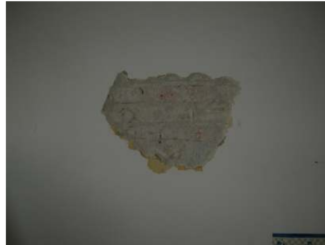
Saggio sulla superficie interna della muratura perimetrale: si nota la tessitura muraria che rivela la presenza di un tavolato in mattoni pieni spesso una testa.
