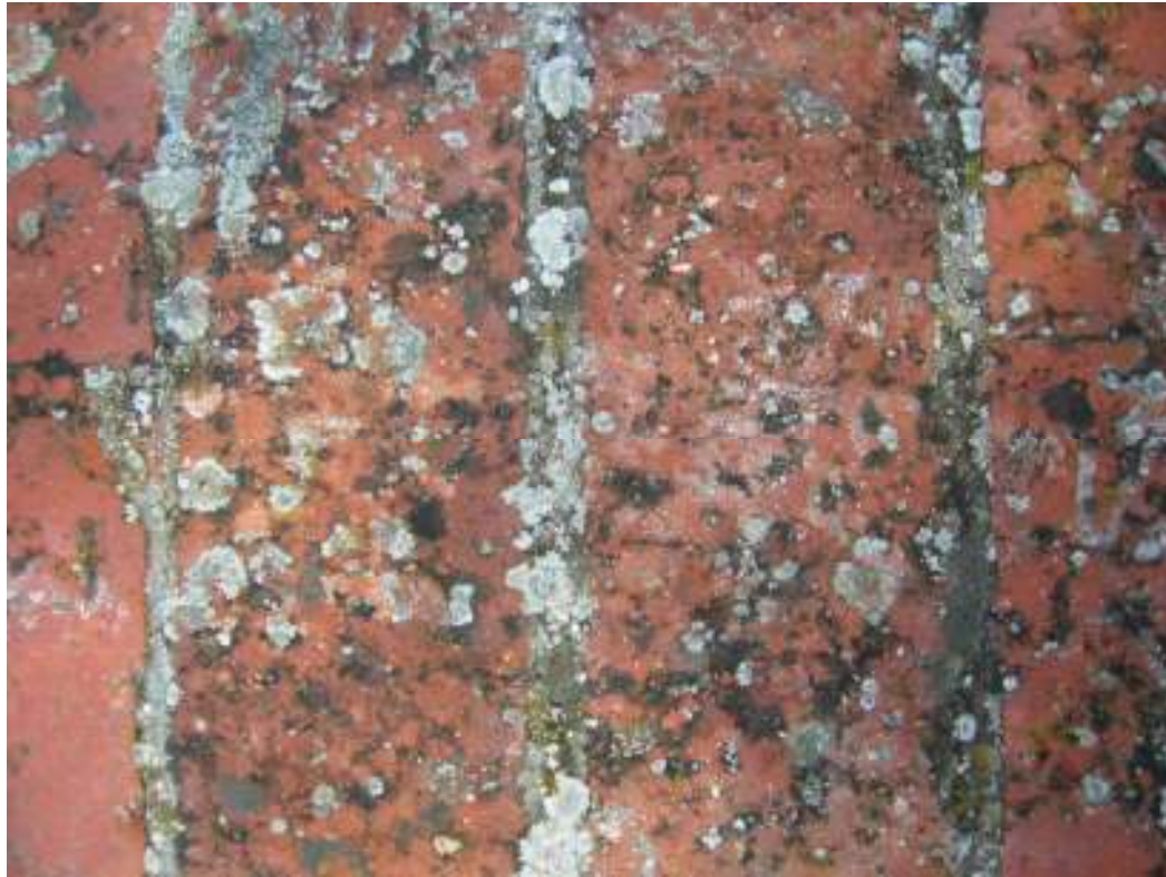
Materiali: particolare dei corsi di impermeabilizzazione della sommità dei muri realizzati in mattoni.
