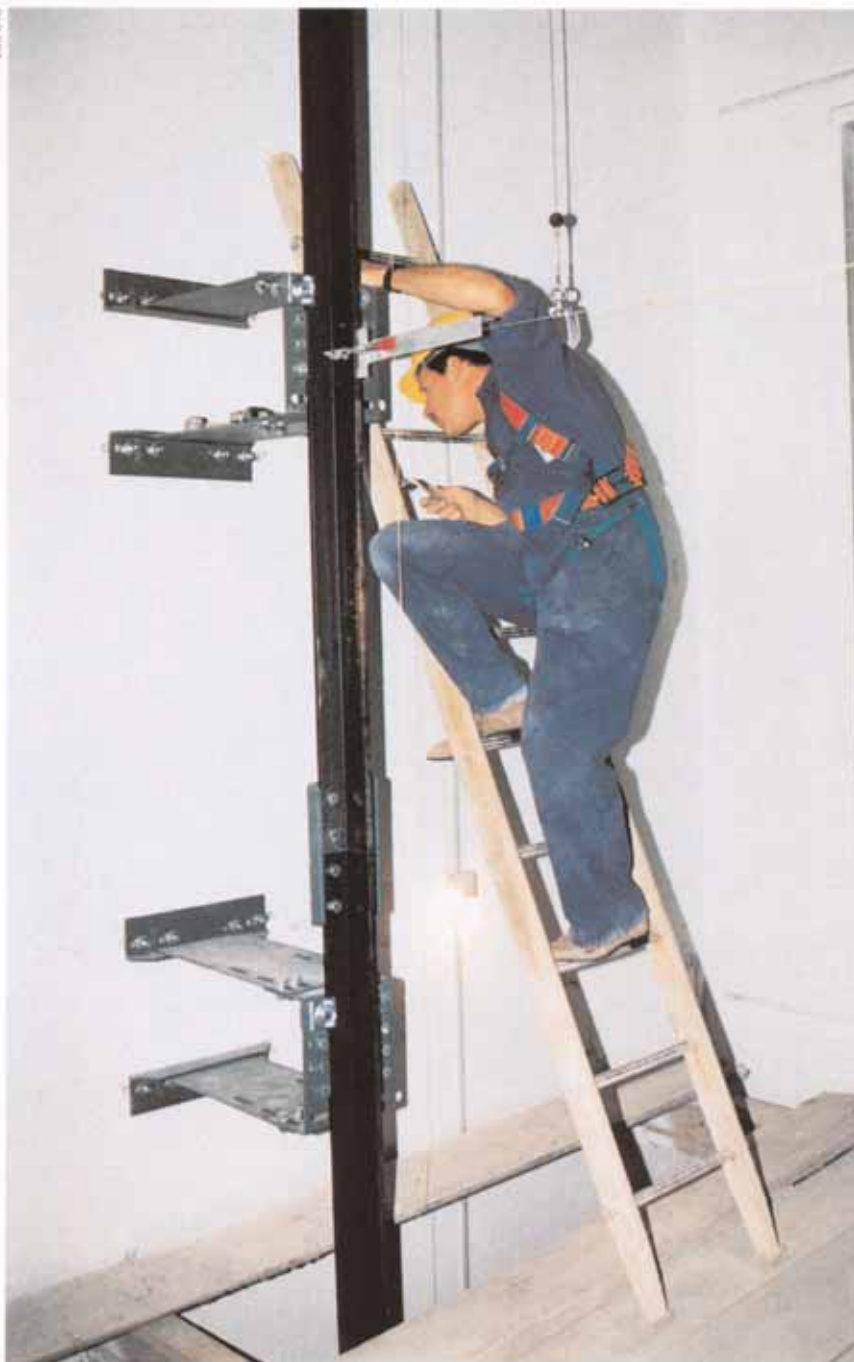
Figura 7 In presenza di aperture nel suolo larghe più di 30 cm esiste il pericolo di caduta nel vuoto. Per lavorare in queste zone la soluzione ideale per proteggersi da cadute è l'uso di cinture anticaduta con fune di trattenuta.
