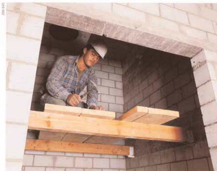
Figura 4 Tavole d'impalcatura di ottima qualità, di spessore sufficiente, sporgenti al massimo 8 cm e inchiodate, costituiscono la premessa per creare posti di lavoro sicuri (a sinistra). Le tavole a trappola (a destra) sono invece un potenziale pericolo di caduta nel vuoto.
