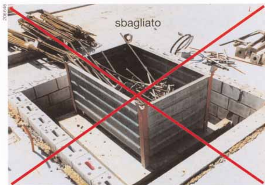
Figura 5 Impalcatura usata abusivamente come deposito di materiale. Il sovraccarico crea una riduzione inammissibile della portata dell'impalcatura.
