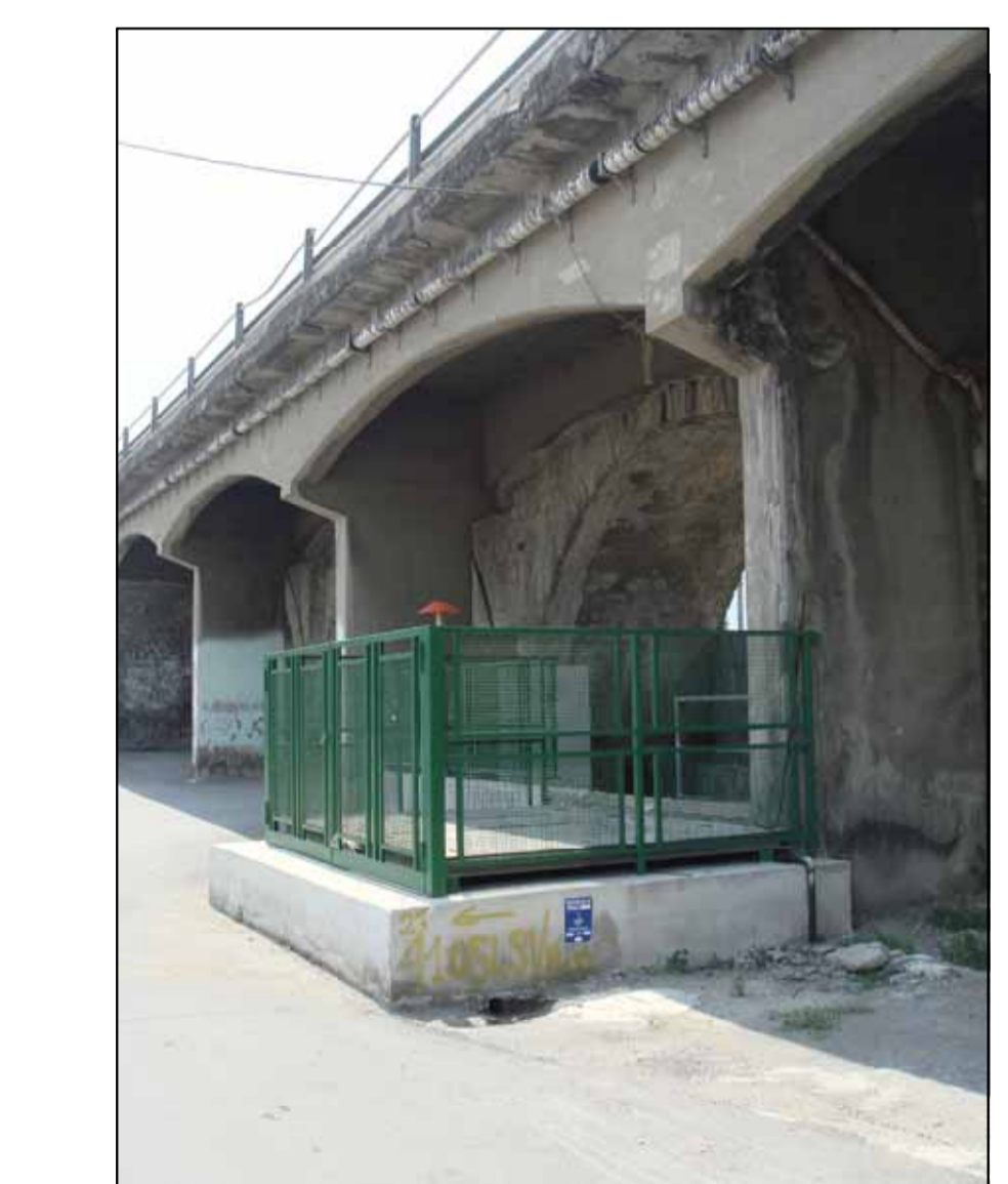
Foto 10: Lato nord, particolare stazione di sollevamento
