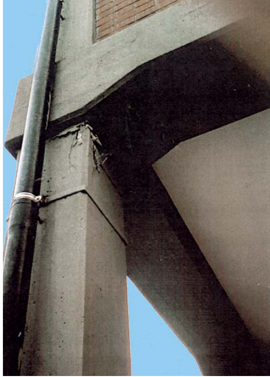
Figura 4.28 Espulsione di copriferro in testa al pilastro, accompagnata da lievi lesioni verticali. Livello del danno: D2-D3 (Bagnolo, RE, 1996)
