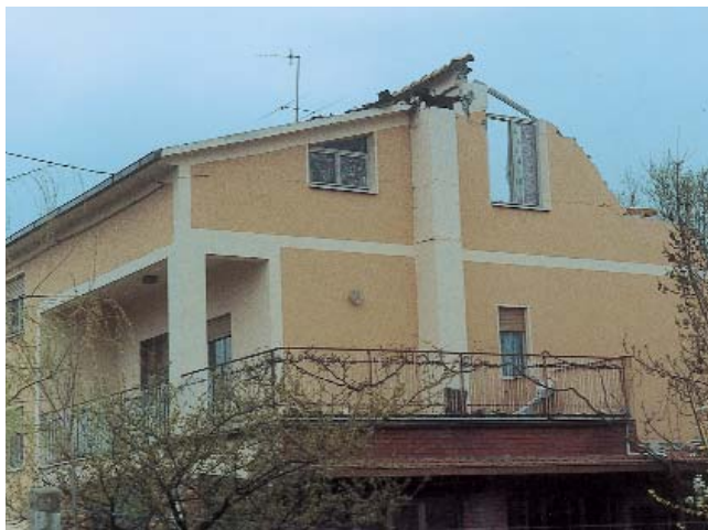
Figura 4.25 Crollo parziale di una copertura in travi di cemento armato e tavelloni senza caldana. Livello del danno alla copertura: D4-D5
