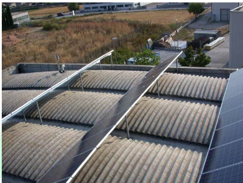
Figura 13 - Esempio di installazione non idonea alla classificazione dell'impianto fotovoltaico nella categoria "su edifici" – Motivazione: l'inclinazione dei moduli fotovoltaici rispetto al piano tangente supera i 10°.
