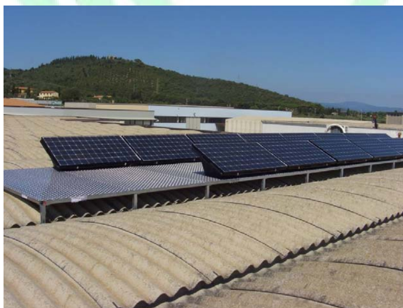
Figura 14 - Esempio di installazione non idonea alla classificazione dell'impianto fotovoltaico nella categoria "su edifici" – Motivazione: i moduli fotovoltaici non sono appoggiati alla superficie di copertura.
