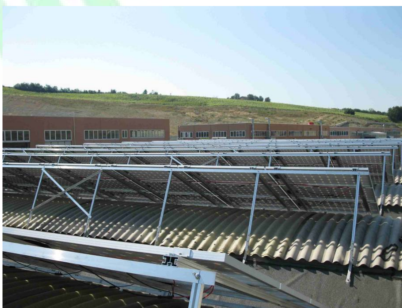
Figura 15 - Esempio di installazione non idonea alla classificazione dell'impianto fotovoltaico nella categoria "su edifici" – Motivazione: alcune file di moduli fotovoltaici non sono appoggiate alla superficie di copertura.
