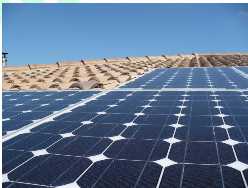
Figura 8 –Esempio di installazione idonea alla classificazione dell’impianto fotovoltaico nella categoria “su edifici” in caso di installazione complanare su un tetto a falda con sostituzione della superficie di copertura
