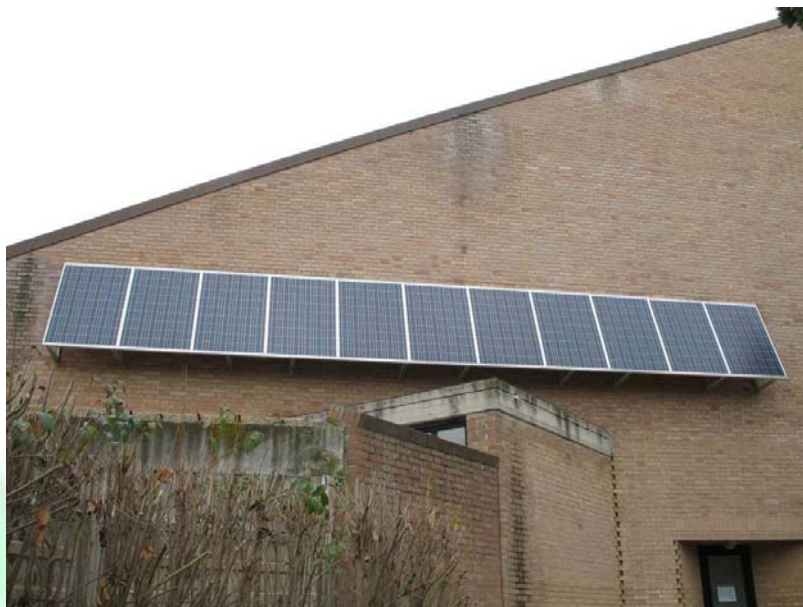
Figura 20 - Esempio di installazione non idonea alla classificazione dell'impianto fotovoltaico nella categoria "su edifici" – Motivazione: la struttura collegata non sottende superfici trasparenti
