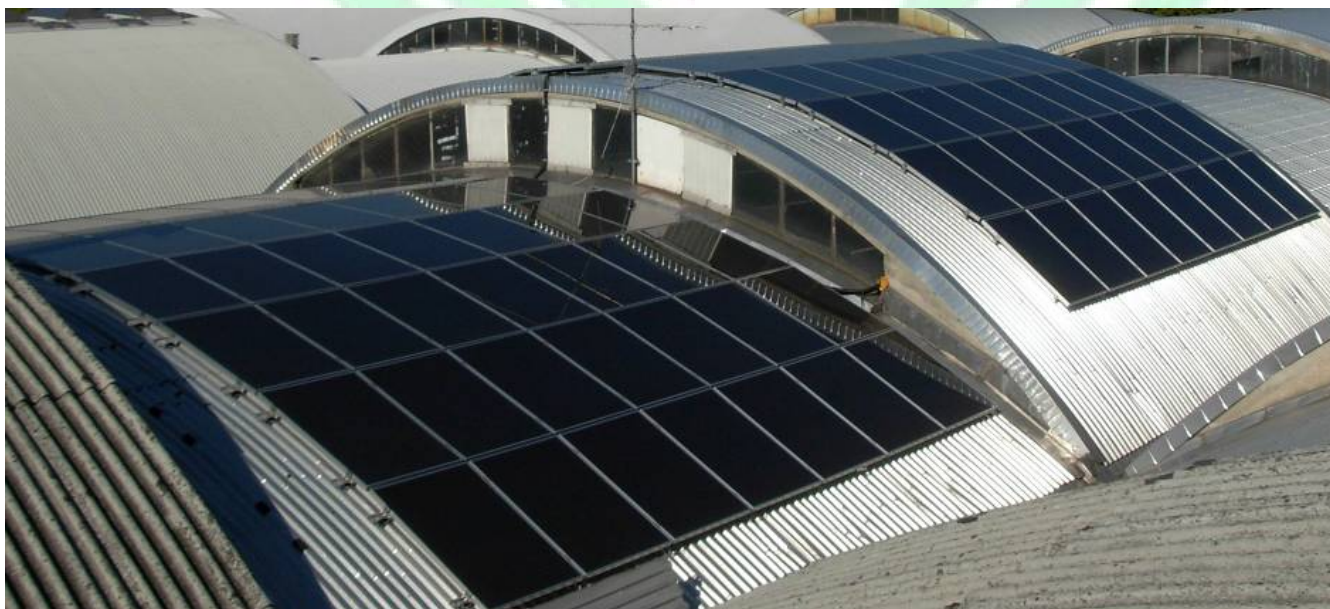
Fig.12 – Esempio di installazione idonea alla classificazione dell'impianto fotovoltaico nella categoria "su edifici" in caso di installazione su una superficie di copertura curva
