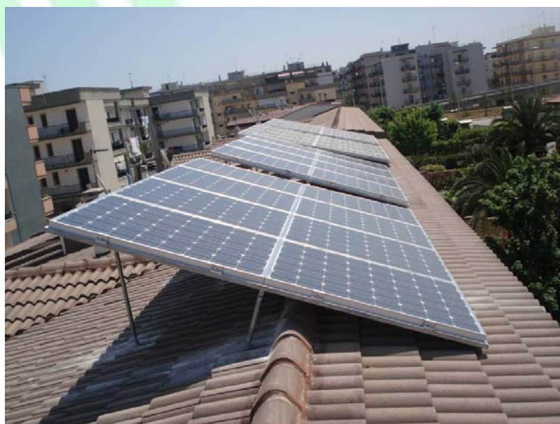
Figura 9 - Esempio di installazione non idonea alla classificazione dell'impianto fotovoltaico nella categoria "su edifici" – Motivazione: i moduli non rispettano la geometria della falda di copertura
