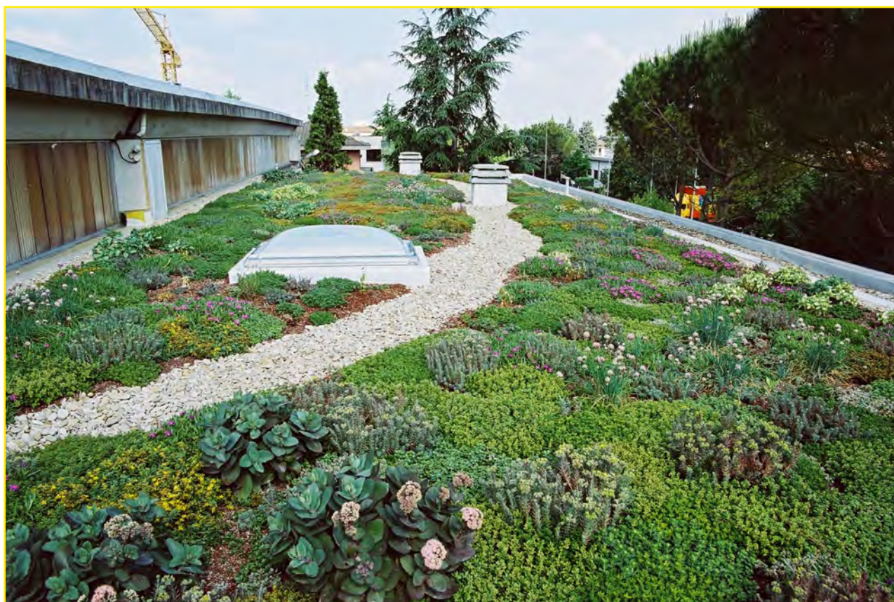
Tetto Verde su copertura azienda Co.Pa.Ri. a Forlì (FC), Fonte DAKU Italia
