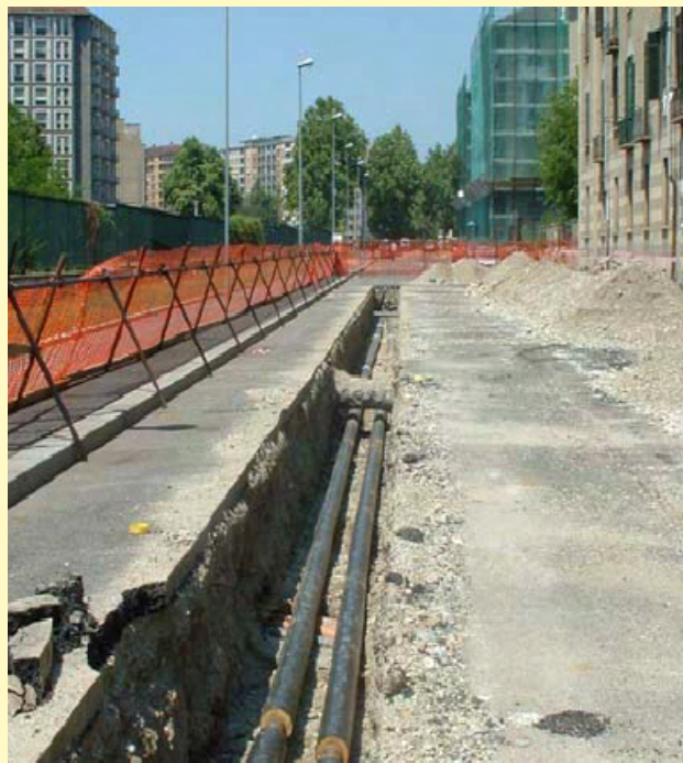
Rete di teleriscaldamento nel quartiere di Arquata, Torino
