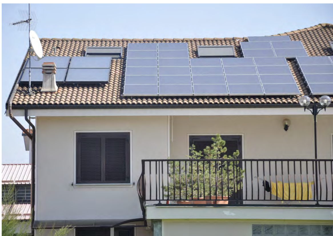
Solare termico e fotovoltaico su abitazione privata, Torre San Giorgio (CN)
