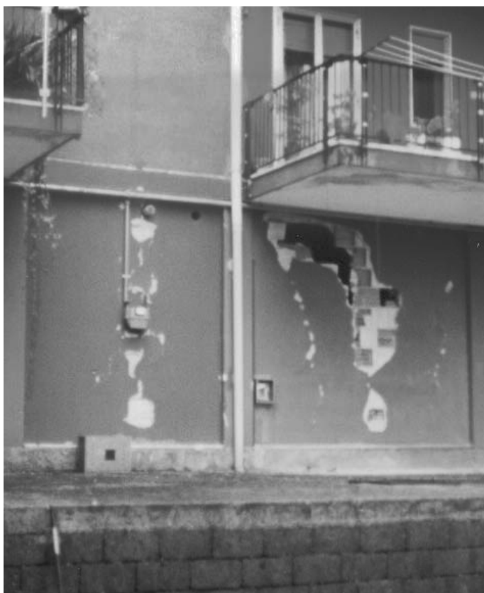
Figura 4.33 Lesioni gravi in tamponature deboli. Livello del danno alle tamponature: D4 (Umbria, 1997)
