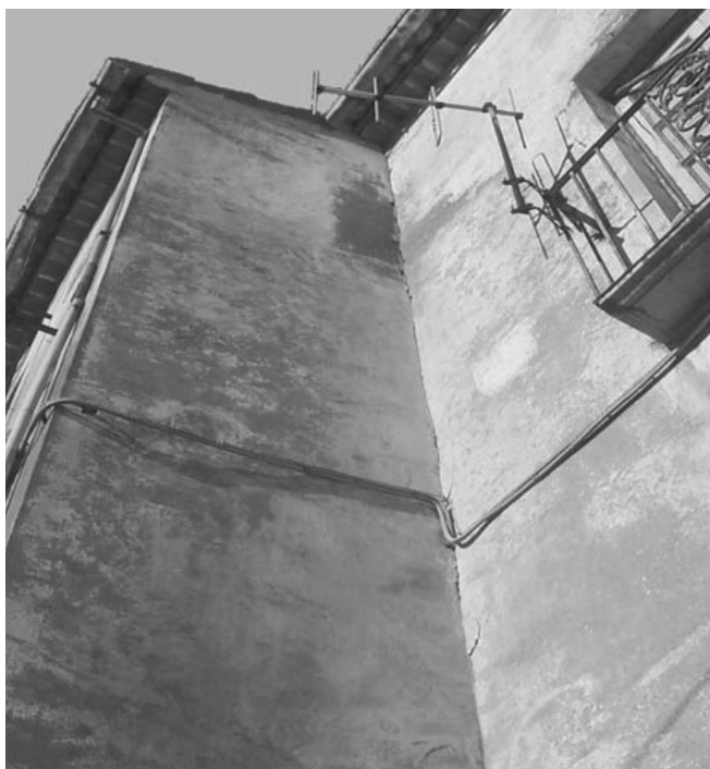
Figura 4.4 Lesioni verticali lungo la connessione dei due corpi di fabbrica (tipo 6). Livello del danno: D1 (Tortora CS, 1998)
