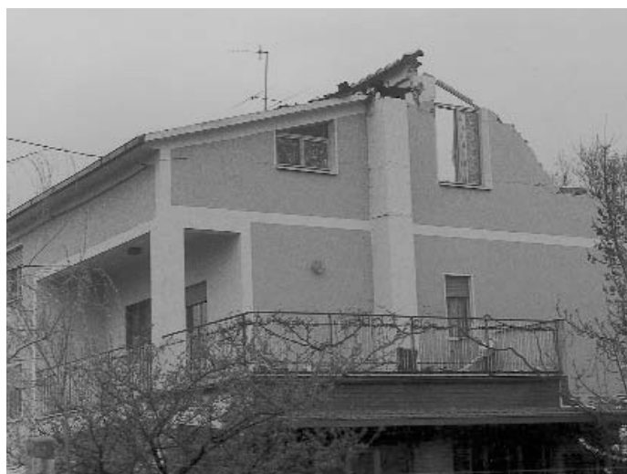
Figura 4.25 Crollo parziale di una copertura in travetti di cemento armato e tavelloni senza caldana. Livello del danno alla copertura: D4-D5
