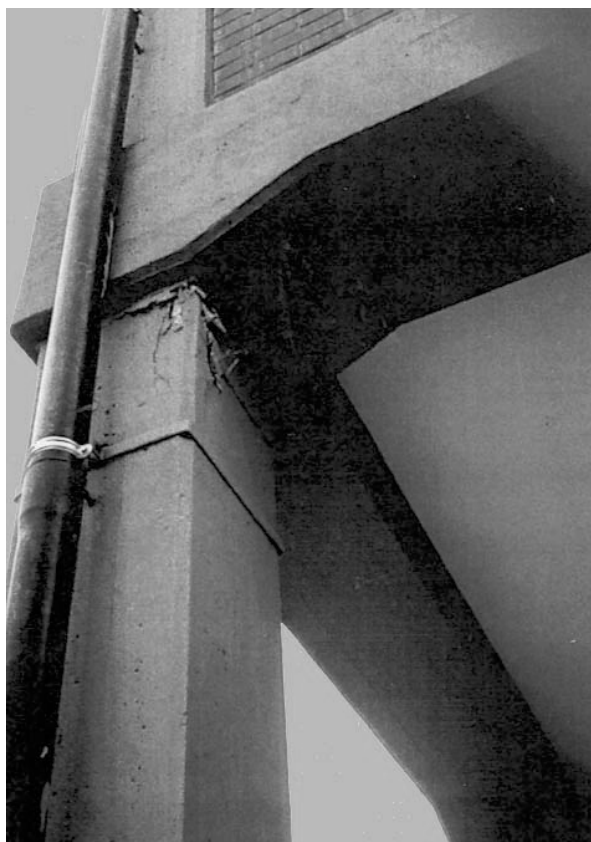
Figura 4.28 Espulsione di copriferro in testa al pilastro, accompagnata da lievi lesioni verticali. Livello del danno: D2-D3 (Bagnolo, RE, 1996)
