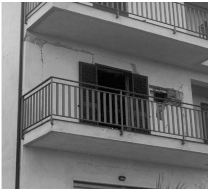
Figura 4.32 Lesioni orizzontali e verticali alla tamponatura, per distacco dalla struttura principale; crollo parziale della tamponatura fra le due porte. Livello del danno alle tamponature: diffuso D2, localmente D4.
