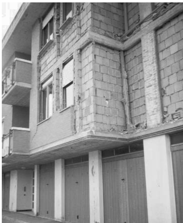
Figura 4.34 Ribaltamento totale di cortine in mattoncini non collegate alla struttura principale. Livello del danno per le tamponature: D4 (Fabriano, 1997)
