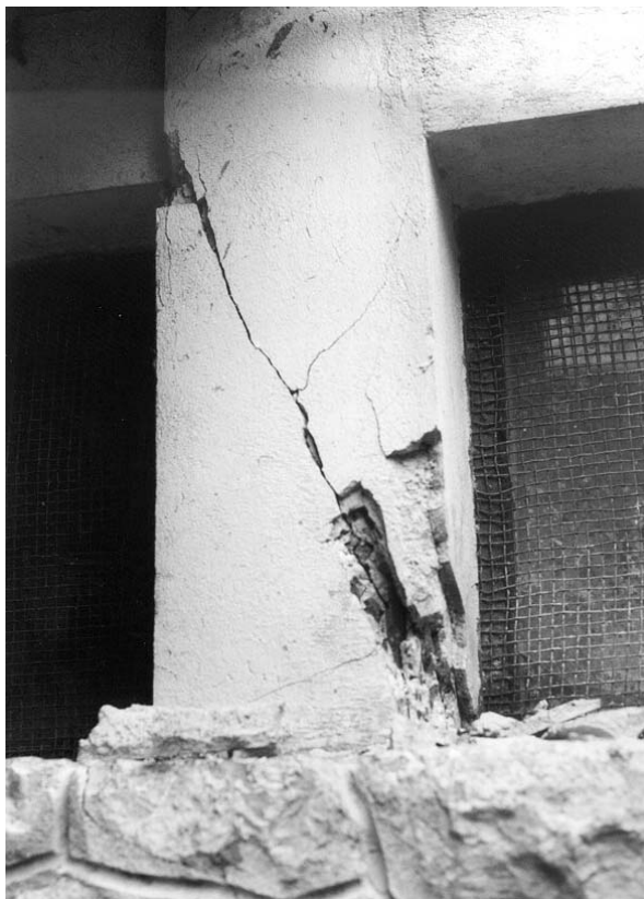
Figura 4.26 Lesione di rottura a pressoflessione e taglio in un pilastro tozzo. Livello del danno: D3, prossimo a D4 (Castelluccio Inferiore, PZ, 1998)
