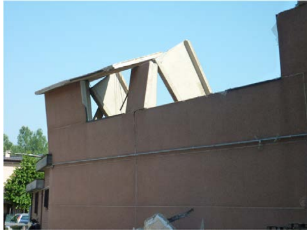
Figura 6 - Perdita di appoggio della trave e collasso della copertura
