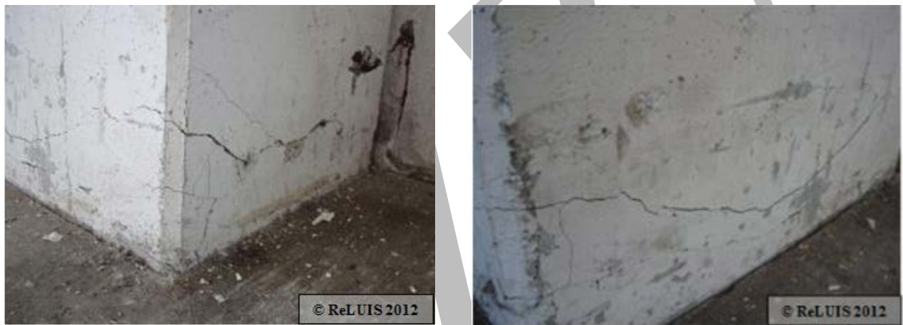
Figura 57 - Fessurazione alla base dei pilastri di un edificio monopiano prefabbricato
