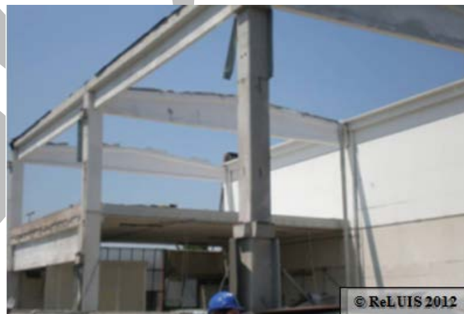
Figura 14 - Collasso dei tegoli di copertura per perdita di appoggio in un edificio prefabbricato con trave principale trasversale
