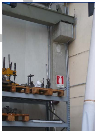
Figura 40 - martellamento tra trave porta-carroponte e pannello tagliafuoco di compartimentazione tra zona produttiva e zona uffici
