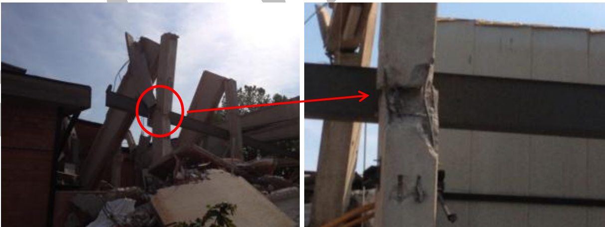
Figura 61 – Formazione cerniera plastica in corrispondenza della mensola tozza, appoggio della trave porta-carroponte
