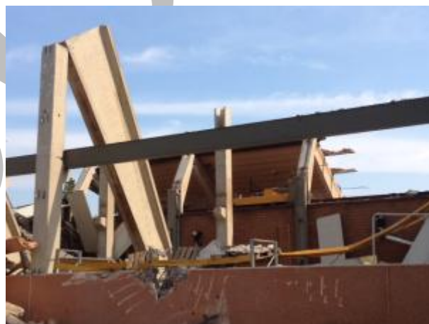
Figura 5 – Perdita di appoggio della trave principale in un edificio monopiano prefabbricato con trave principale trasversale
