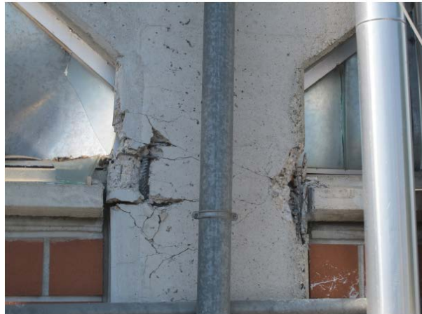
Figura 62 - Danneggiamento del pilastro tozzo causa interazione con la tamponatura
