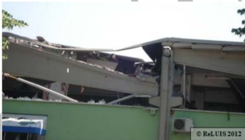
Figura 1 - Perdita di appoggio della trave in un edificio monopiano prefabbricato con trave principale trasversale di non recente costruzione
