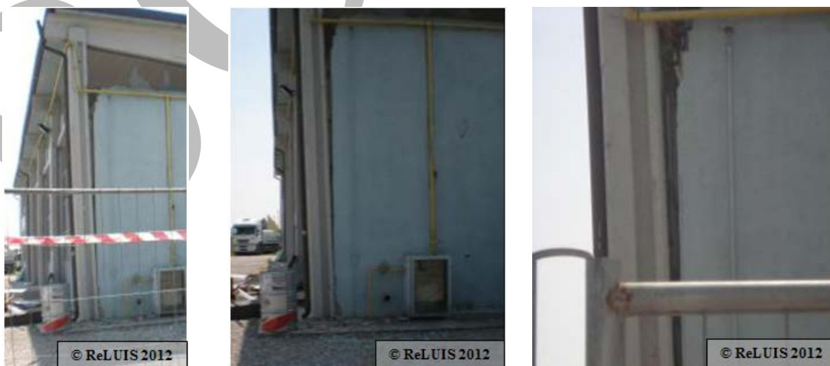
Figura 49 – Perdita di verticalità del pilastro con fessurazione alla base
