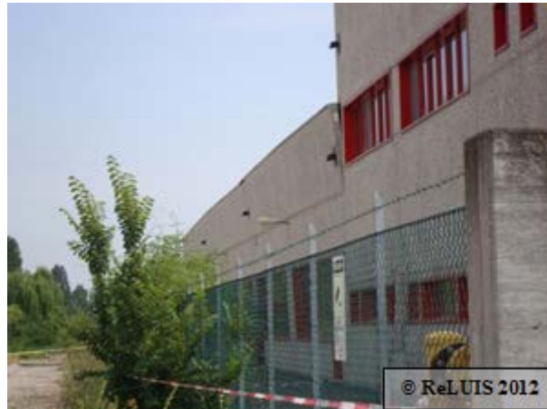
Figura 32 – Collasso incipiente dei pannelli orizzontali di tamponamento in un edificio monopiano prefabbricato
