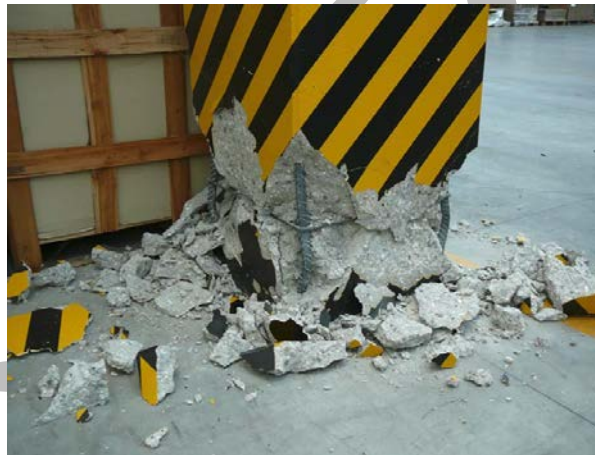
Figura 60 - Cerniera plastica alla base del pilastro
