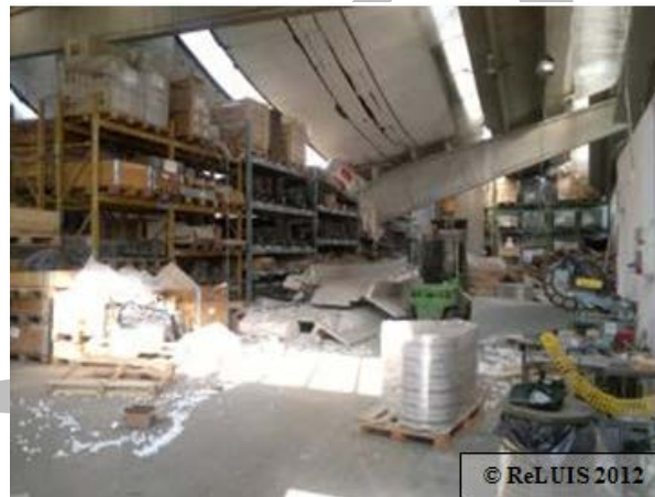
Figura 4 – Perdita di appoggio dei tegoli in un edificio monopiano prefabbricato con trave principale trasversale, che probabilmente ha causato il collasso della trave trasversale
