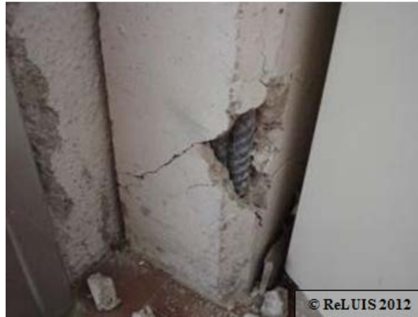
Figura 59 – Espulsione del copriferro alla base del pilastro con carenza di armature trasversali
