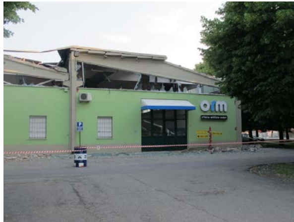
Figura 9 - Perdita di appoggio delle travi in un edificio monopiano prefabbricato con trave principale trasversale
