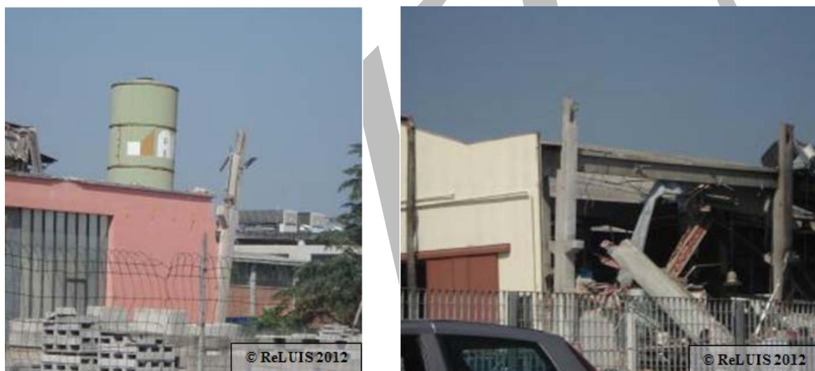
Figura 48 – Perdita di verticalità dei pilastri per probabile problema in fondazione
