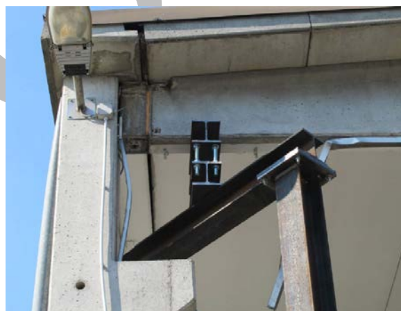
Figura 11 - Perdita di appoggio della trave con inserimento di dispositivo di sostegno temporaneo
