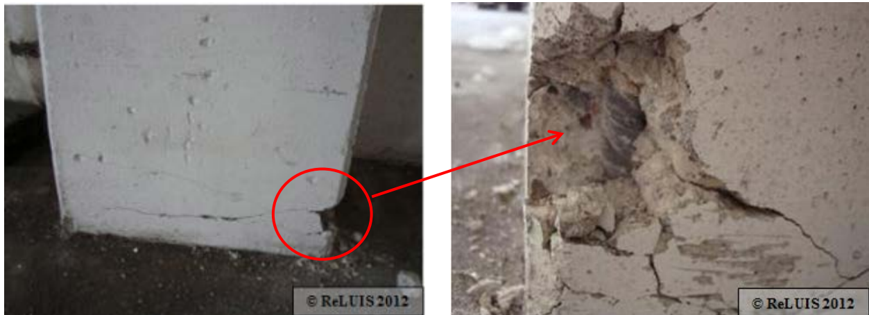
Figura 56 – Incipiente formazione di cerniera plastica alla base del pilastro con consistente fessurazione
