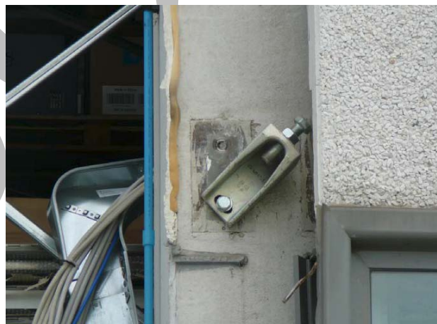
Figura 37 - Rottura attacco mensola di supporto pannello e conseguente crollo del pannello
