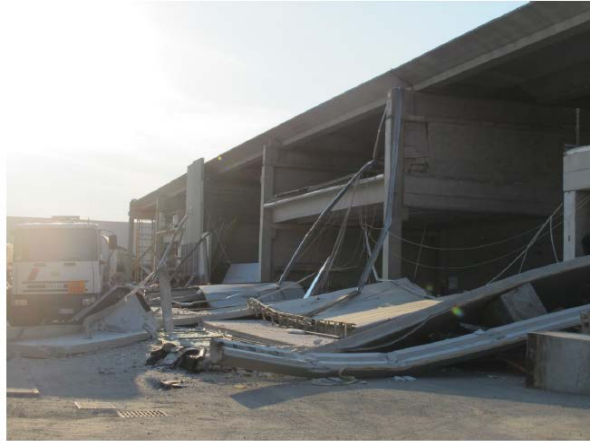
Figura 43 –Collasso pannelli verticali di tamponatura di un edificio prefabbricato
