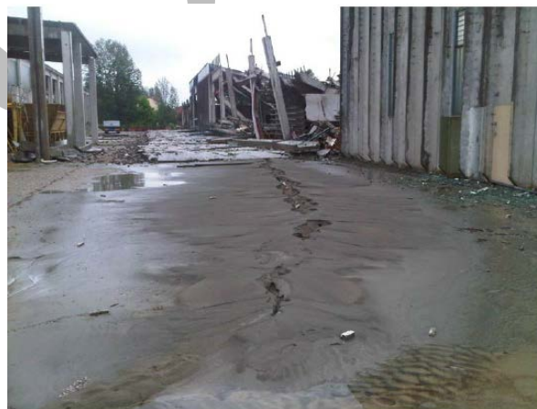
Figura 52 - Collasso dovuto alla rotazione dei pilastri in fondazione causata da fenomeni di liquefazione
