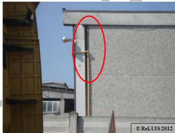
Figura 51 – Perdita di verticalità del pilastro
