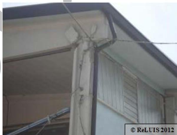
Figura 19 – Crisi della forcella in testa ai pilastri per martellamento della trave in un edificio monopiano prefabbricato con trave principale trasversale
