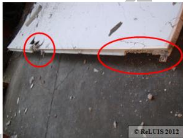
Figura 20 – Collasso di una lastrina di copertura in un edificio monopiano prefabbricato con trave principale longitudinale
