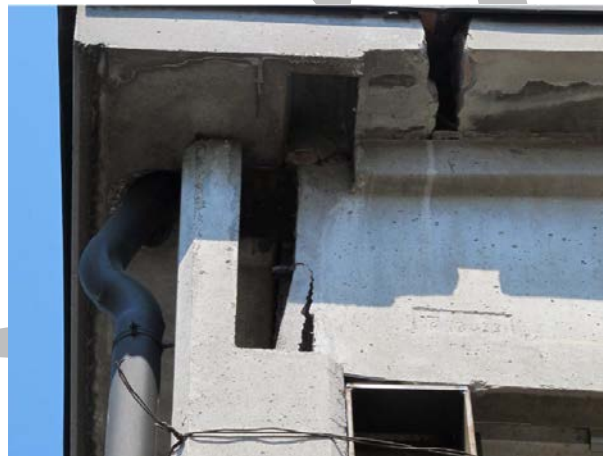
Figura 10 - Perdita quasi completa dell'appoggio della trave
