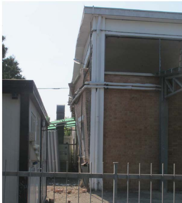
Figura 46 –Crisi per meccanismo fuori dal piano di un pannello di tamponatura in laterizio in un edificio monopiano prefabbricato
