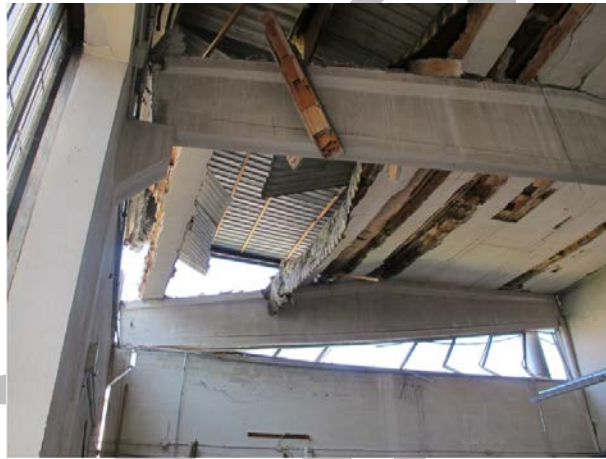
Figura 7 - Perdita di appoggio della trave in un edificio monopiano prefabbricato con trave principale trasversale
