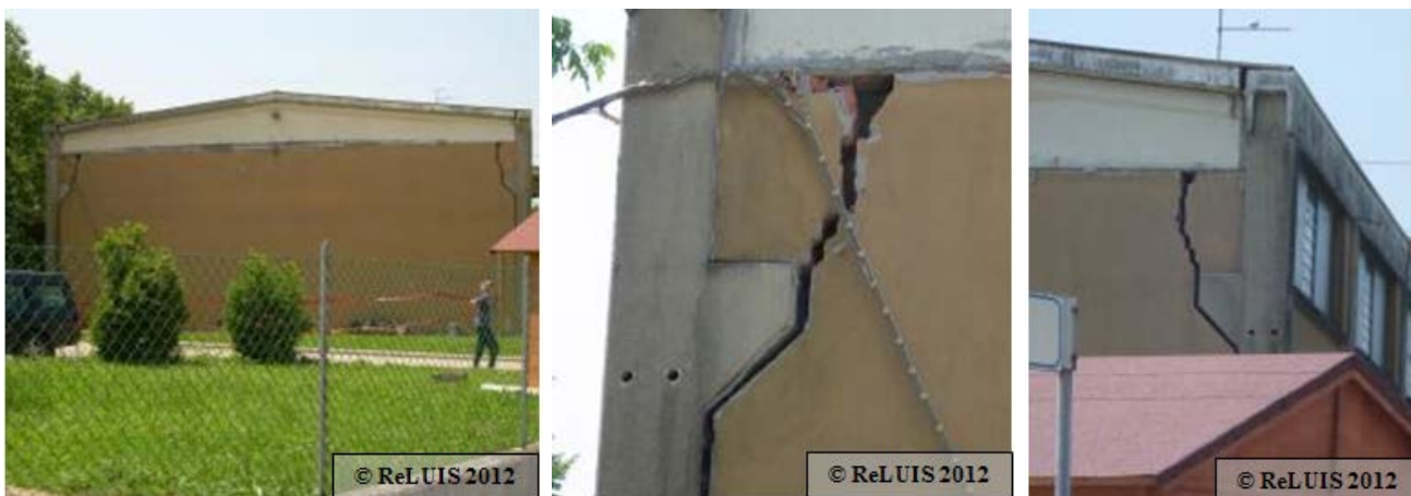
Figura 47 – Perdita di verticalità dei pilastri in un edificio monopiano prefabbricato per possibile, ma non accertato, problema a livello della fondazione
