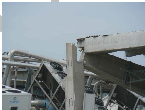
Figura 17 - Collasso capriata per perdita di appoggio
