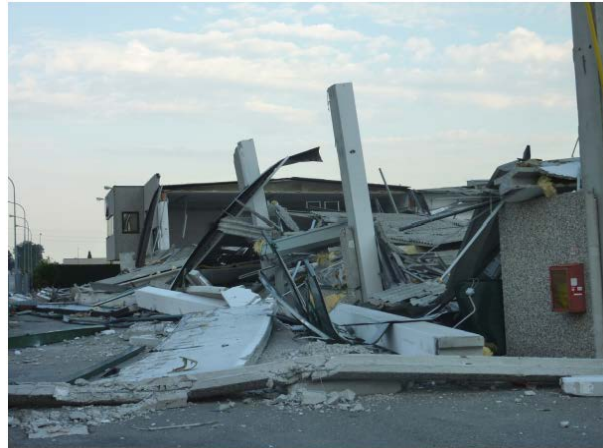
Figura 53 – Collasso globale dell'edificio: perdita di verticalità del pilastro
