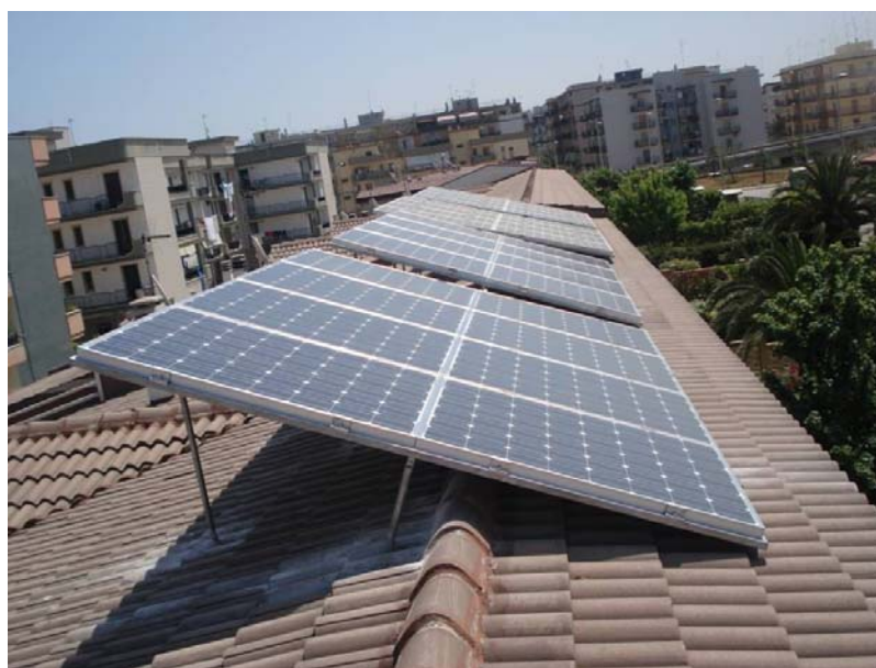
Figura 10 - Esempio di installazione non idonea alla classificazione dell'impianto fotovoltaico nella categoria "su edifici" – Motivazione: i moduli non rispettano la geometria della falda di copertura
