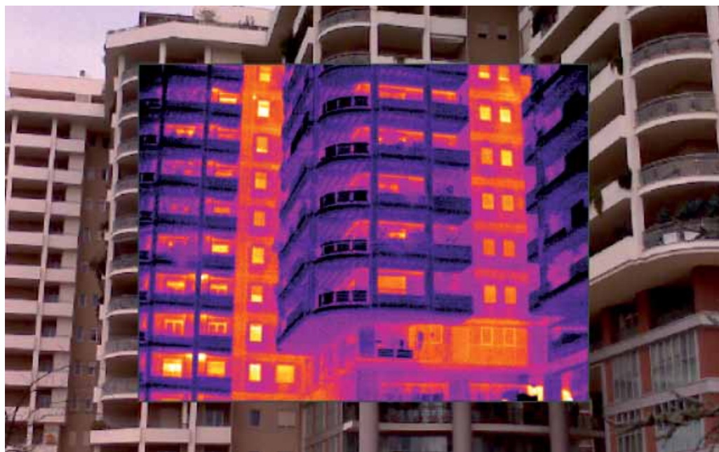
Nuovi edifici con in evidenza la presenza di ponti termici in prossimità dei solai e dei pilastri, Bari
