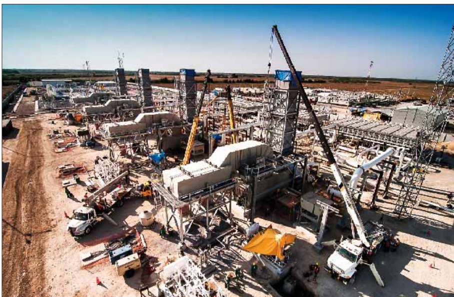
MESSICO BONATTI Stazione di compressione Los Ramones I
