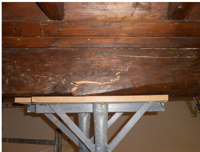
Foto 6 – Rottura a flessione su trave di solaio in pioppo.
