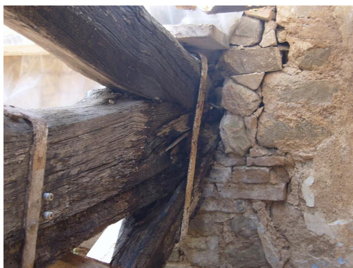
Foto 5 – Degrado da carie in appoggio di capriata.
