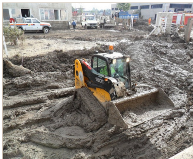
Foto 2.3.5 – Benevento: Rimozione dell'ingente quantitativo di detriti nella zona industriale, dopo il passaggio
