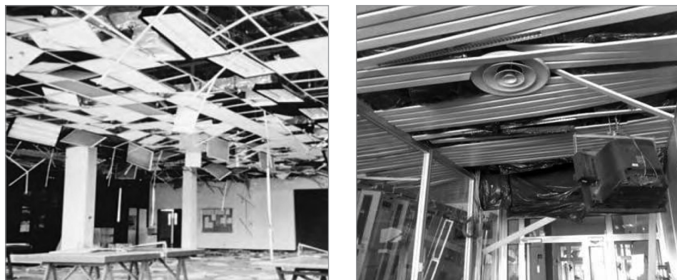
Figura 13.2. Danni causati dal crollo di controsoffittature
