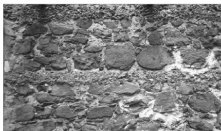
Presenza di ricorsi in conglomerato cementizio.
