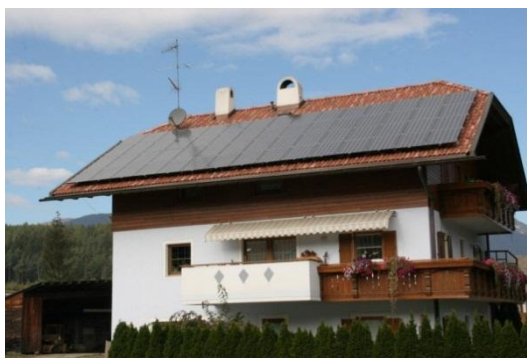
Figura 7 – Esempio di installazione idonea alla classificazione dell'impianto fotovoltaico nella categoria "su edifici" in caso di installazione complanare su un tetto a falda
