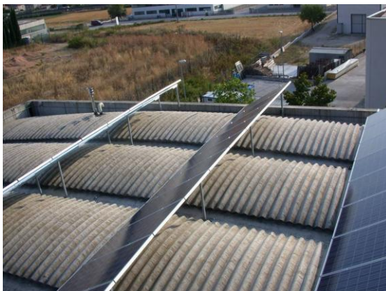
Figura 16 - Esempio di installazione non idonea alla classificazione dell'impianto fotovoltaico nella categoria "su edifici" – Motivazione: i moduli non sono disposti secondo il piano tangente
