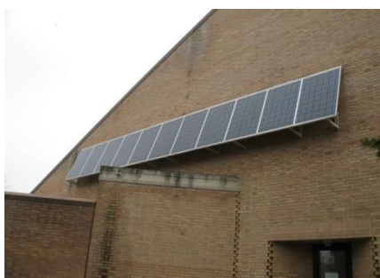
Figura 25 - Esempio di installazione non idonea alla classificazione dell’impianto fotovoltaico nella categoria “su edifici” – Motivazione: la struttura collegata non sottende superfici trasparenti
