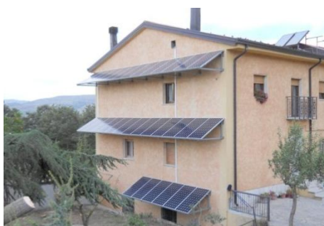
Figura 24 - Esempio di installazione non idonea alla classificazione dell’impianto fotovoltaico nella categoria “su edifici” – Motivazione: la lunghezza dell’impianto fotovoltaico supera il doppio della lunghezza delle aperture trasparenti sottese
