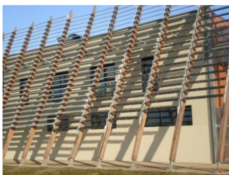
Fig. 22 – Esempio di installazione idonea alla classificazione dell'impianto fotovoltaico nella categoria "su edifici"
