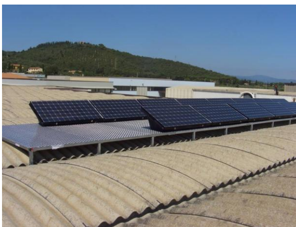
Figura 17 - Esempio di installazione non idonea alla classificazione dell'impianto fotovoltaico nella categoria "su edifici" – Motivazione: i moduli fotovoltaici non sono appoggiati alla superficie di copertura.
