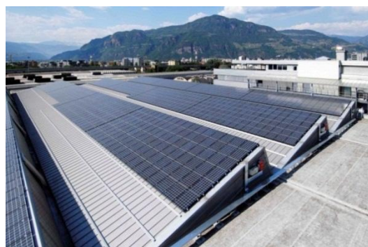
Figura 8 – Esempio di installazione idonea alla classificazione dell'impianto fotovoltaico nella categoria "su edifici" in caso di installazione complanare su un tetto a falda senza sostituzione della superficie di copertura
