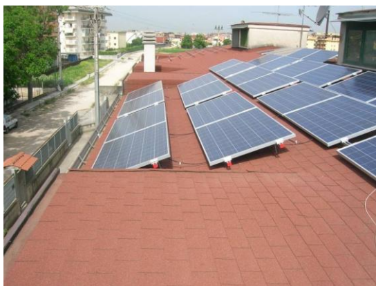
Figura 9 - Esempio di installazione non idonea alla classificazione dell'impianto fotovoltaico nella categoria "su edifici" – Motivazione: i moduli non sono complanari alla falda di copertura
