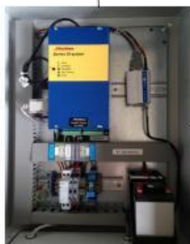
Centralina di acquisizione
