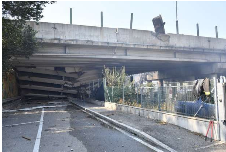
Figura 7 – Il crollo dell'impalcato
