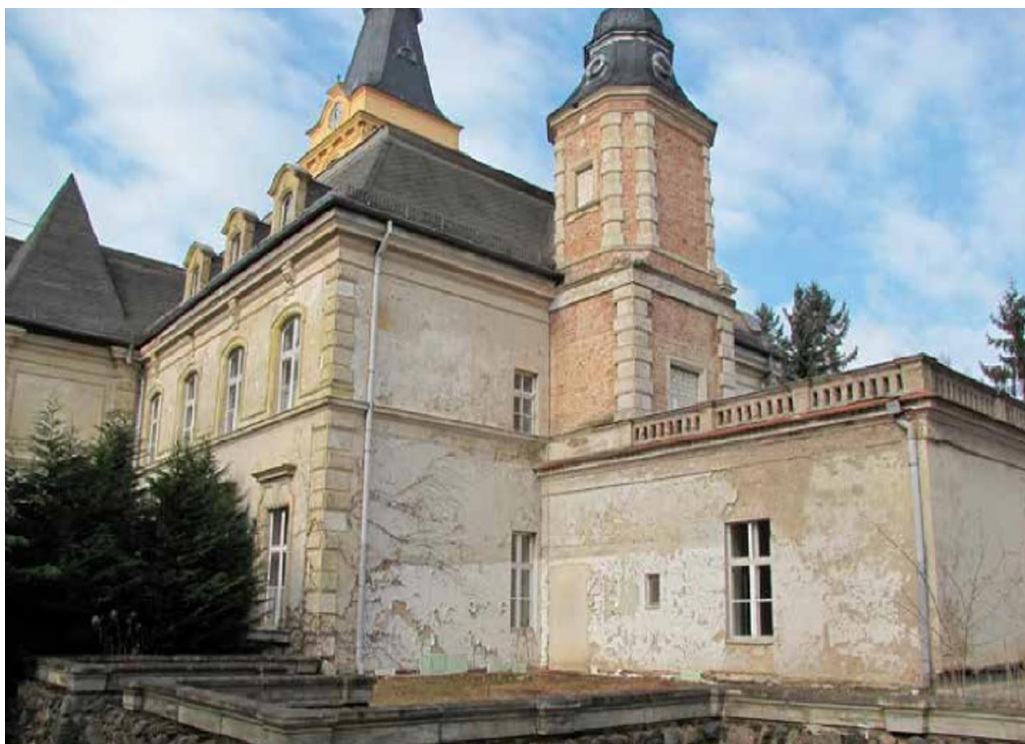
Figura 2 Esempio di edificio storico con evidenti forme di degrado sulla muratura. Fonte: Xella
