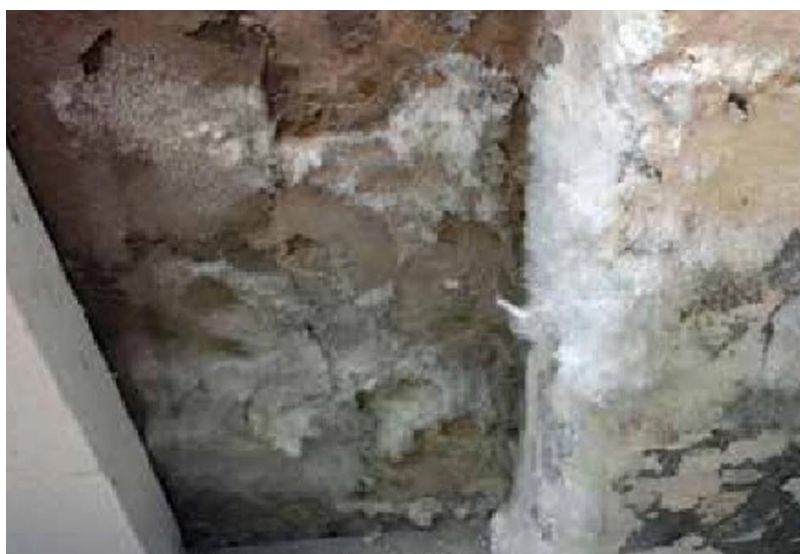
Figura 4 Esempio di formazione di efflorescenze saline su una parete perimetrale. Fonte: Xella
