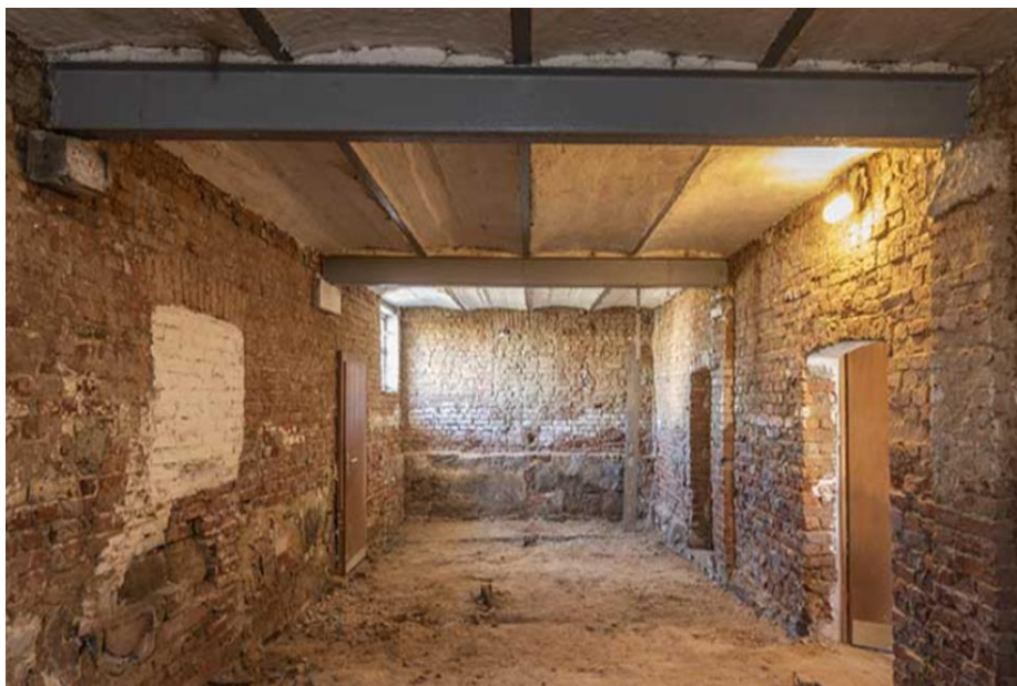
Figura 1 Esempio di edificio storico da risanare per problemi di umidità con muratura perimetrale in mattoni pieni. Fonte: Xella
