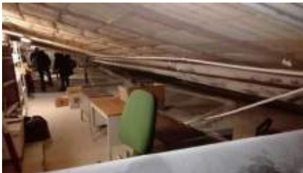
Fig. 9 – linea di distribuzione termicamente isolata nel sottotetto
