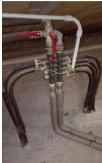
Fig. 10 – I collettori di distribuzione posizionati nel sottotetto
