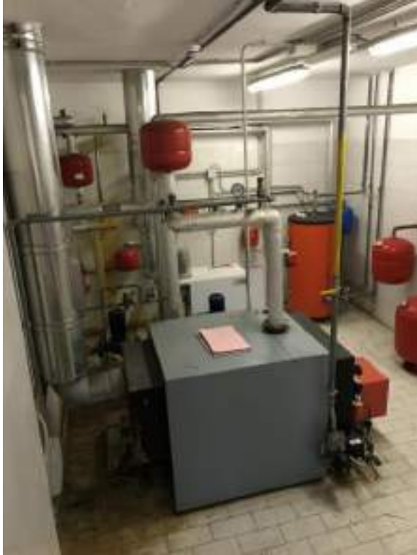
Fig.7 – Immagine della centrale termica: in evidenza le due caldaie a basamento per i servizi riscaldamento e ACS
